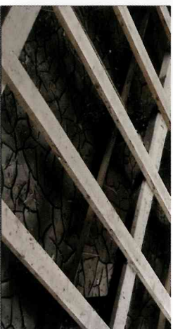
床下にたまった泥 (写真③)
