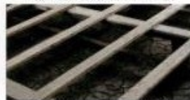
床下にたまった泥(写真③)
